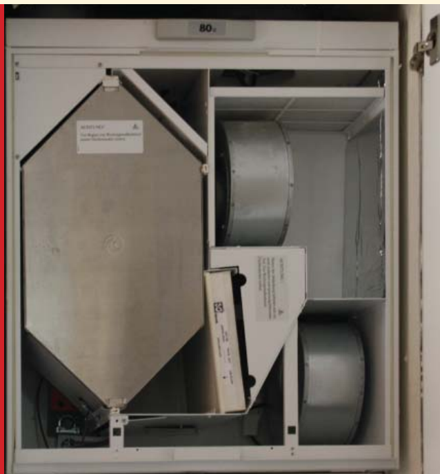
Вентилационна инсталация с рекуператор на топлината
